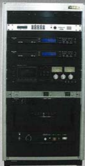
POOL SYSTEM プール用音響設備
